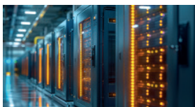
Telecom y centros de datos
