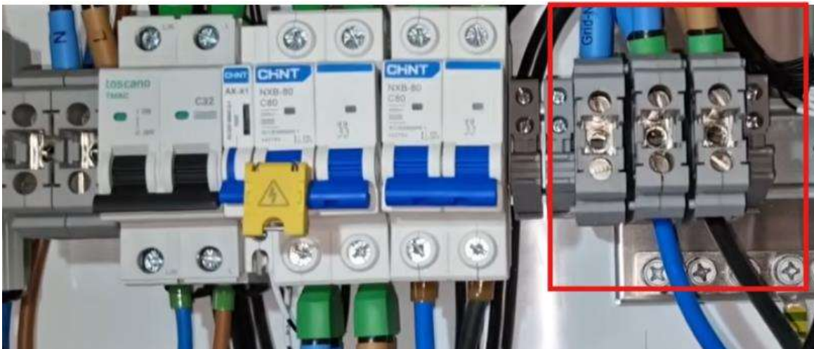
Imagen 4. En rojo, salida de M-Backup hacia cuadro de distribución de la vivienda
