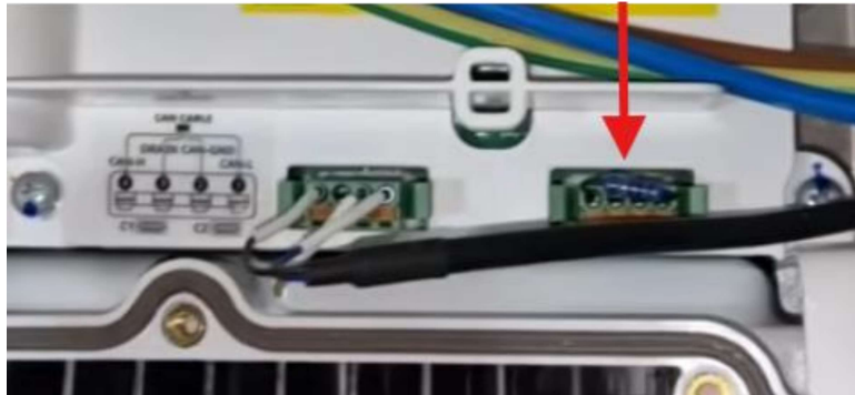
Imagen 11. Final de Bus de comunicación de batería
