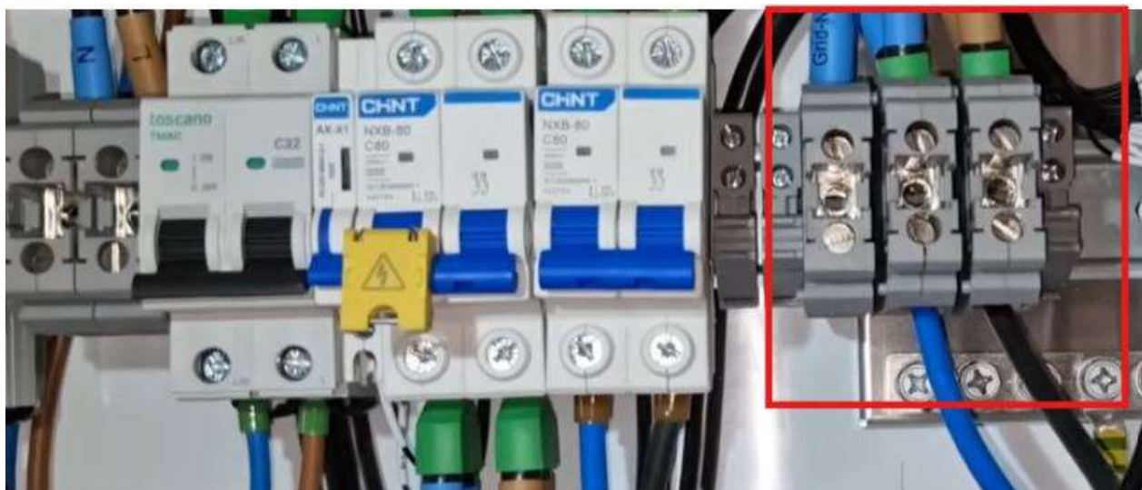
Imagen 4. Salida hacia cuadro principal de la vivienda
