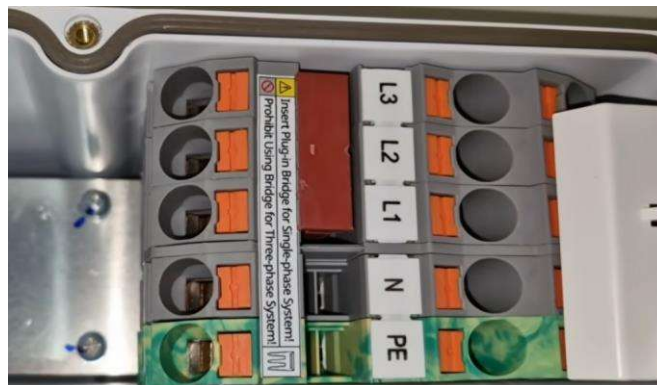
Imagen 7. Puente de Batería obligatorio conectar en escenario monofásico
