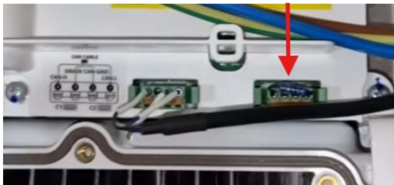
Imagen 15. Final de Bus de comunicación de batería
