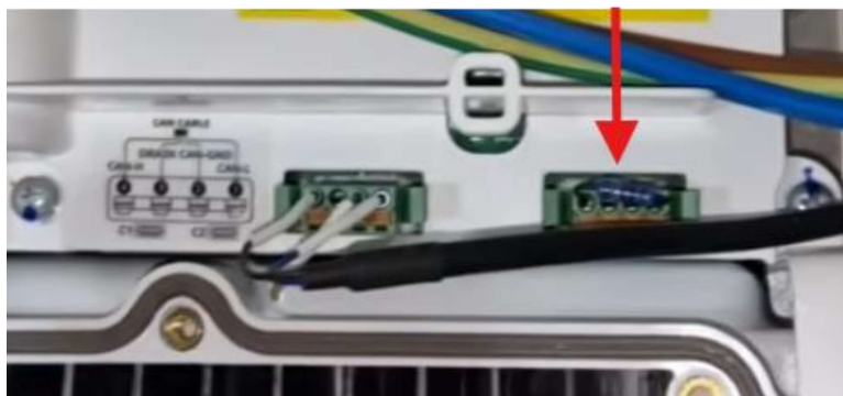
Imagen 15. Final de Bus de comunicación de batería
