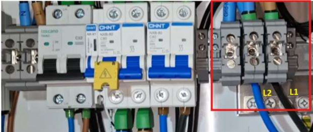
Imagen 5. Salida hacia cuadro principal de la vivienda
